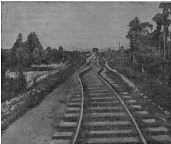
Рис. 5. Разрушения, причиняемые сильным землетрясением
